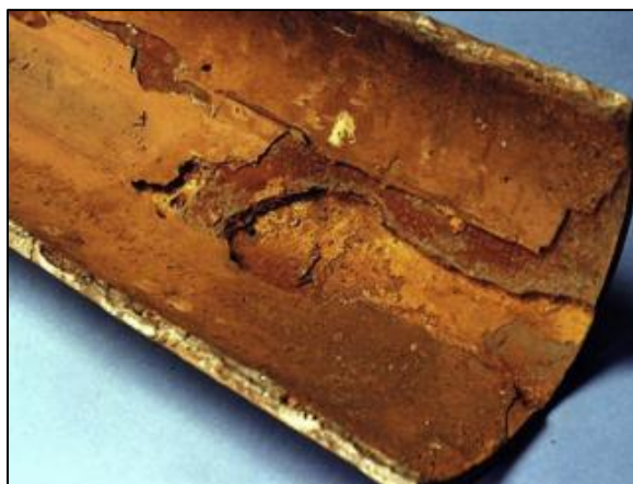
Figura 5. Daños por corrosión por CO 2 y agua salada
