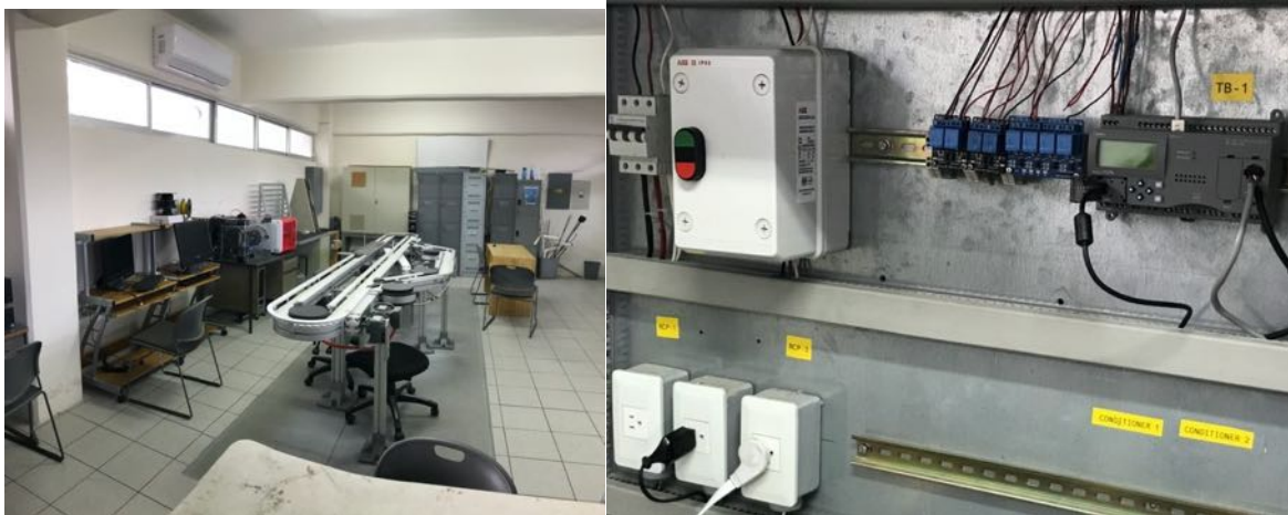
Figura 18. Banda transportadora y panel de control del laboratorio de robótica.
