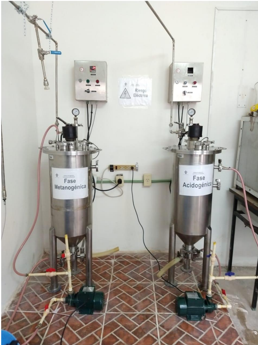
Planta piloto de digestión anaerobia
