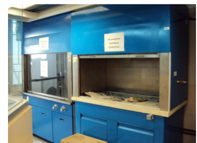
Campana de extracción
