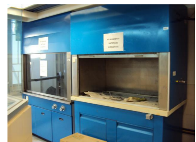
Campana de extracción
