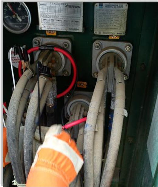
Figura 2. Conexión del Analizador de redes en transformador para alumbrado.
