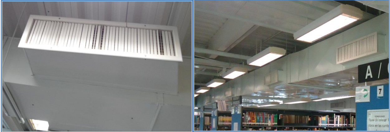
Fig. 11. Rejillas cerradas en el CADi y en la zona de libros.
