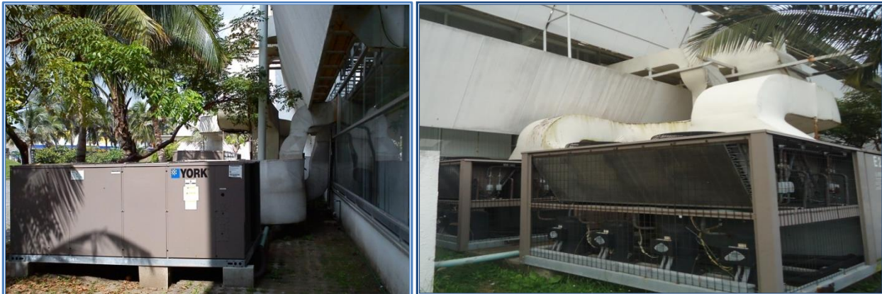
Fig. 8. Equipos de aire acondicionado instalados en la USBI.
