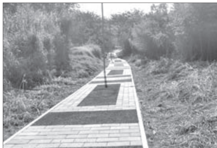
La obra es de concreto ecológico y tiene 19 luminarias
