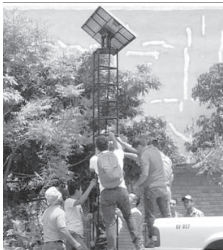
En la primera etapa se colocaron fotosensores
