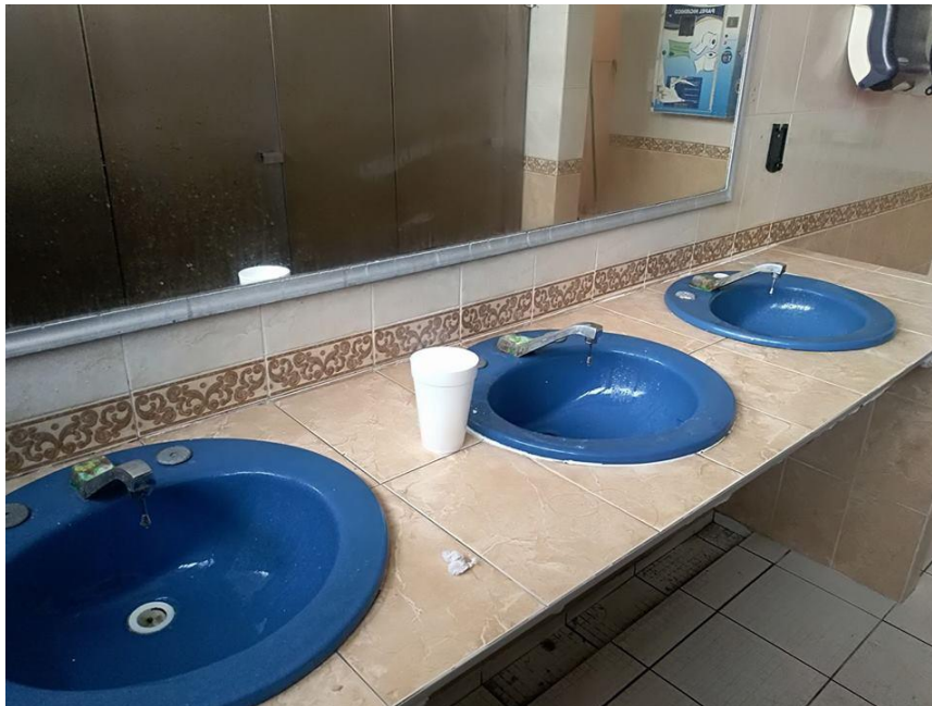
Apéndice 9: Área de lavabos de los sanitarios de mujeres, con goteo constante en las llaves de agua (foto tomada el 09 de febrero de 2018)
