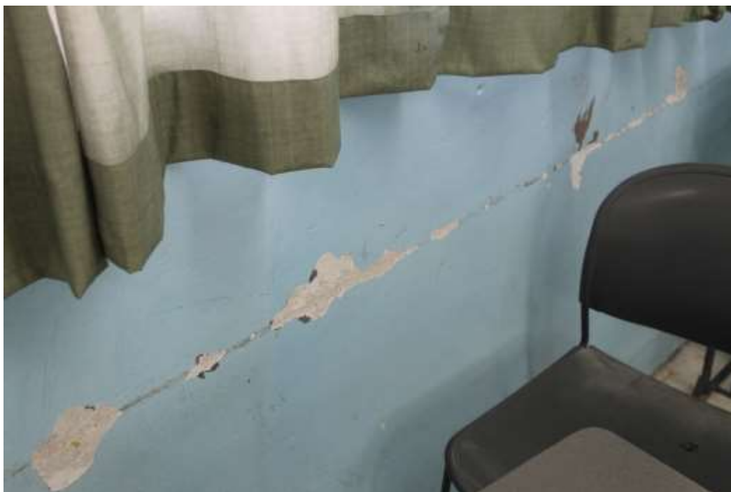
FOTOGRAFÍA DE UNA DE LAS PAREDES DE LAS AULAS, ANTES DE DARLE EL MANTENIMIENTO CORRECTIVO.
