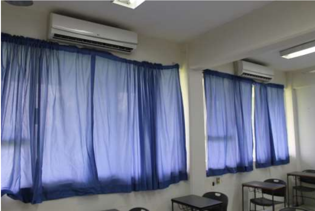
FOTOGRAFÍA DE OTRA DE LAS PAREDES DE LAS AULAS, ANTES DE DARLE EL MANTENIMIENTO CORRECTIVO.
