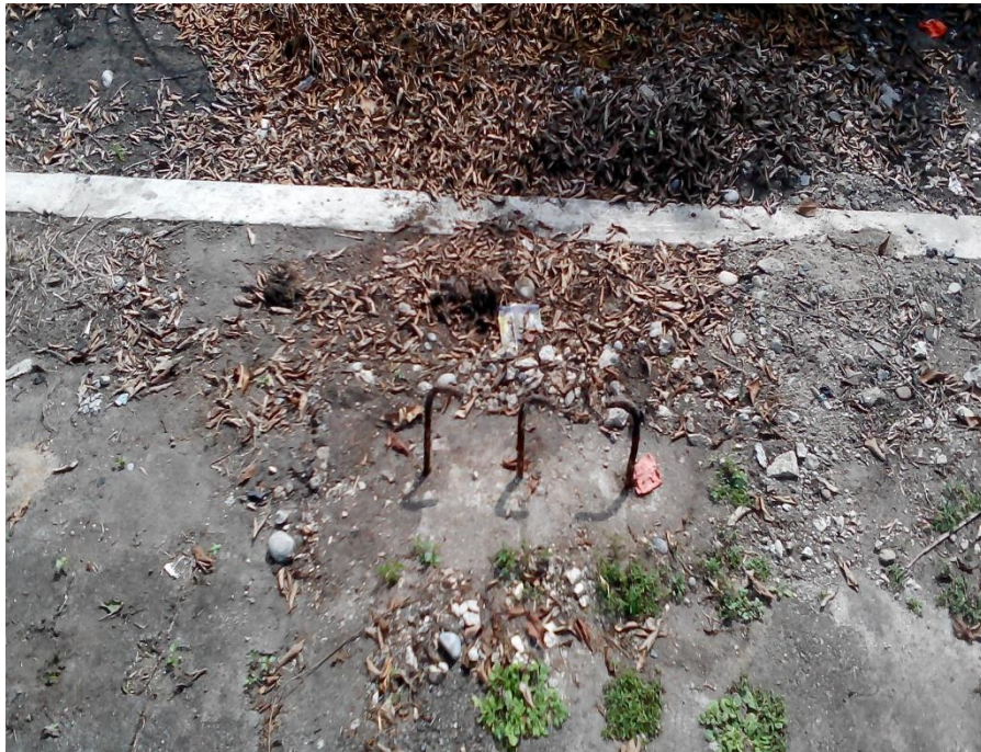
Deterioro de los topes de los cajones
