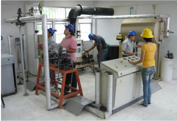
Planta de Vapor
