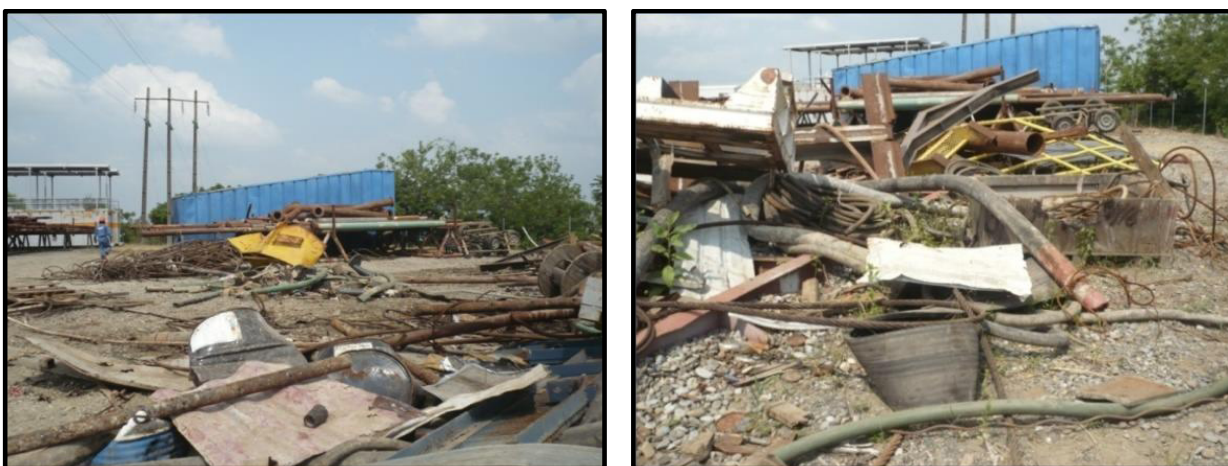
Figura 15. Área de almacenamiento temporal de RME.
