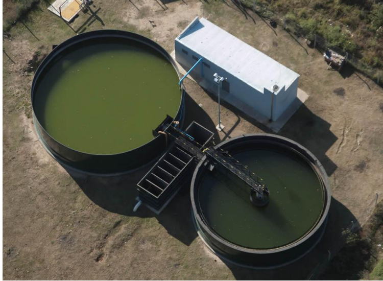
Figura 11. Vista de una planta tratadora con lodos activados.
