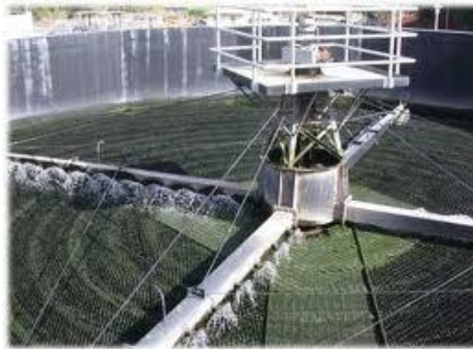
Figura 14. Planta tratadora con filtros percolados.
