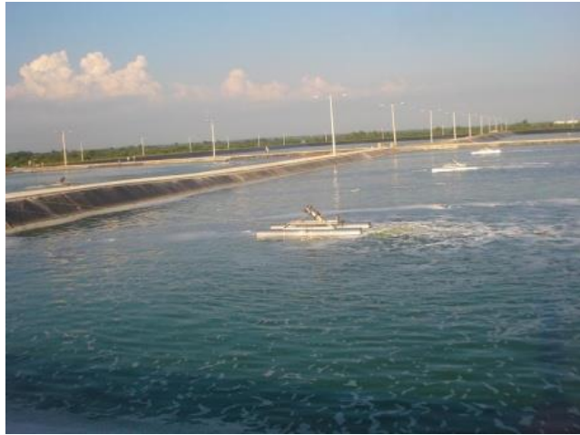
Figura 19. Laguna aerobia en el tratamiento de aguas negras.
