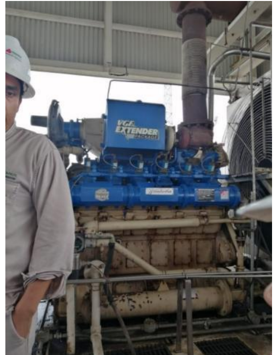
La bomba quintuple la cual es el motor a dicha La cual por lo regular se usan 2 pero por fallas Tenían que operar con 1 según también las presiones
