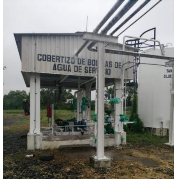
Cobertizo de bombas de agua de servicio
