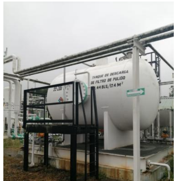
Tanque de descarga de filtro pulido segun los procesos de desarenamiento o de sorbedor
