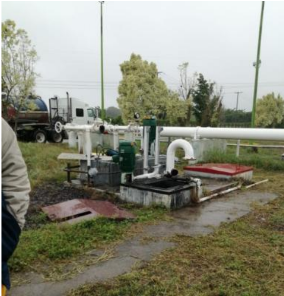
Se revisaron las líneas de gas ,así como la de liquido de los CAB Tajín y Poza Rica
