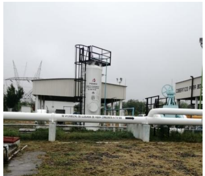
Tanque de almacenamiento de aceite
