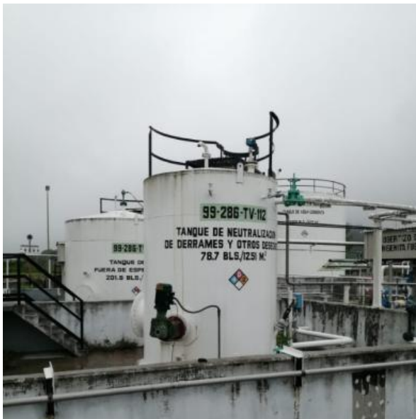
Tanque de neutralización de derrames y otros desechos la cual los desechos químicos van a unas fosa y de ahí van al contenedor TV-100
