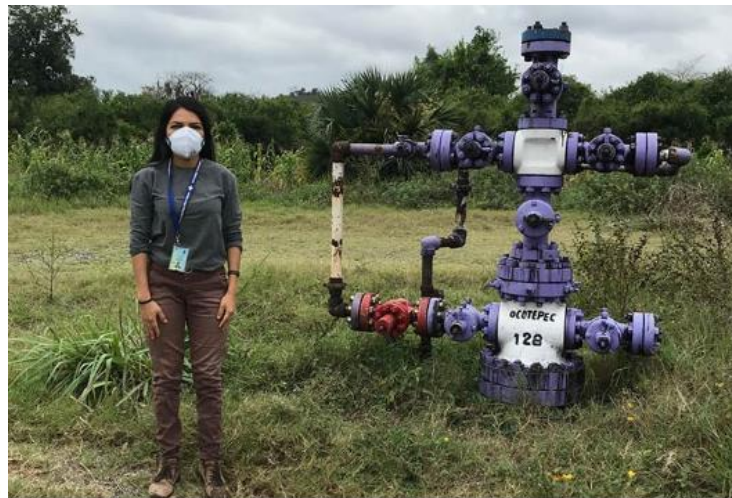
Pozo en la localidad de Chichimantla en el municipio de Tihuatlán
