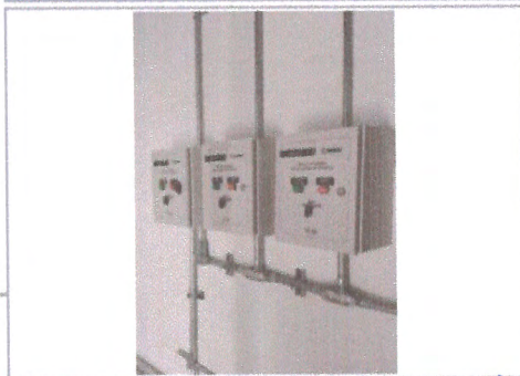
F3: Equipo de control de bombeo
