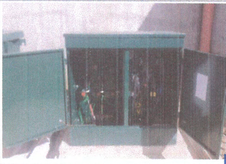
F3: Edificio (B) Transformadores
