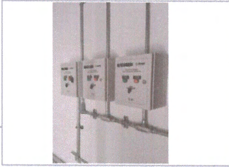
F3: Equipo de control de bombeo
