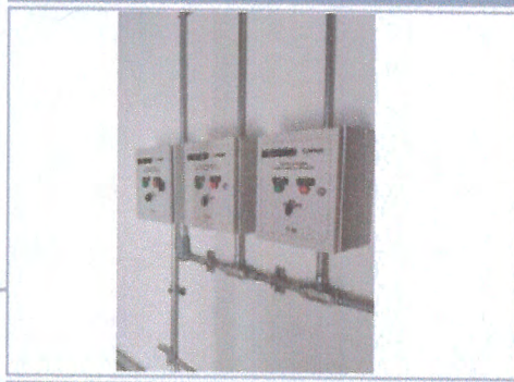
F3: Equipo de control de bombeo
