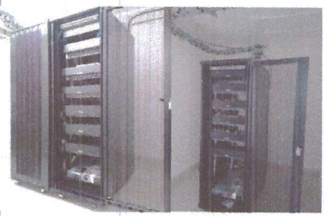
F3: Gabinetes dentro de los sito de segundo y tercer nivel
