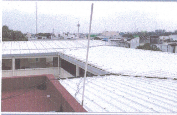
F4: Cubierta multipanel ya reparada y colocada vista desde la cubierta misma.
