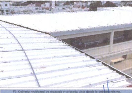
F3: Cubierta multipanel ya reparada y colocada vista desde la cubierta misma.
