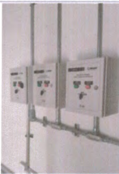
F3: Equipo de control de bombeo
