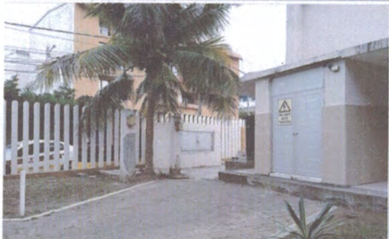
F4: En esta fotografía se observa el gabinete donde se colocaran las barras derivadoras. Dicho gabinete ya se encuentra terminado solo está a la espera de la aplicación de la pintura exterior.
