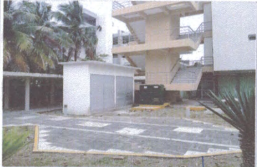
F3: En esta fotografía se observa el transformador ya colocado, así como el cuarto de tableros terminado, solo esperando la pintura exterior.
