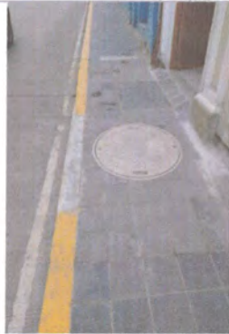
F1: Registro de media tensión
