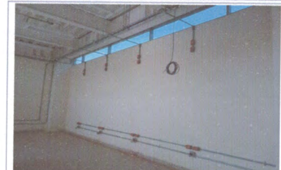
F5: Edificio C instalación eléctrica
