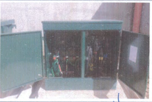
F3: Edificio (B) Transformadores
