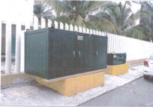
F1: En esta fotografía se observa que el transformador y el equipo de medición ya fueron montados sobre sus bases de concreto. Estos equipos se encuentran sobre la banqueta de la calle Costa Dorada.
