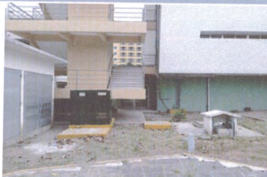
F2: En esta fotografía se observa que el transformador de 800 KVA ya fue instalado sobre la base prefabricada. A la izquierda de la foto se observa el cuarto de tableros ya terminado, solo esperando la aplicación de la pintura exterior.
