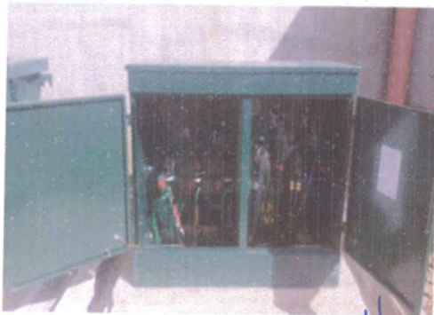
F3: Edificio (B) Transformadores
