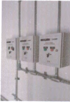
F3: Equipo de control de bombeo
