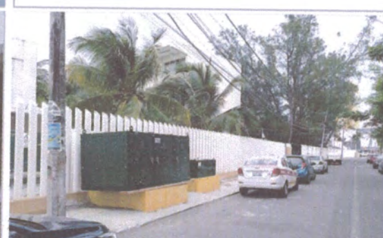
F5: Bases de concreto ya terminadas y transformador y equipo de medición ya montados sobre ellas.
