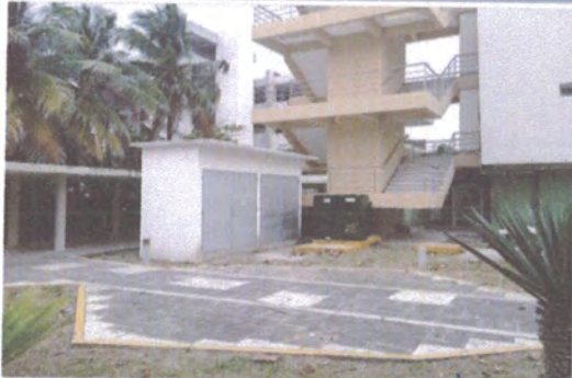
F3: En esta fotografía se observa el transformador ya colocado, así como el cuarto de tableros terminado, solo esperando la pintura exterior.
