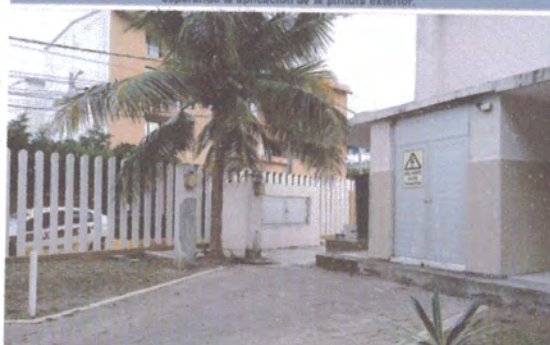
F4: En esta fotografía se observa el gabinete donde se colocaran las barras derivadoras. Dicho gabinete ya se encuentra terminado solo está a la espera de la aplicación de la pintura exterior.
