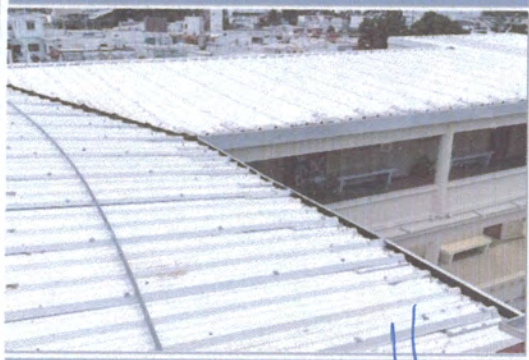
F3: Cubierta multipanel ya reparada y colocada vista desde la cubierta misma.
