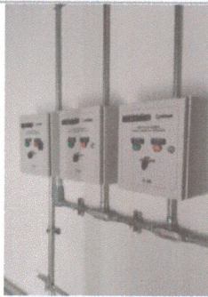
F3: Equipo de control de bombeo
