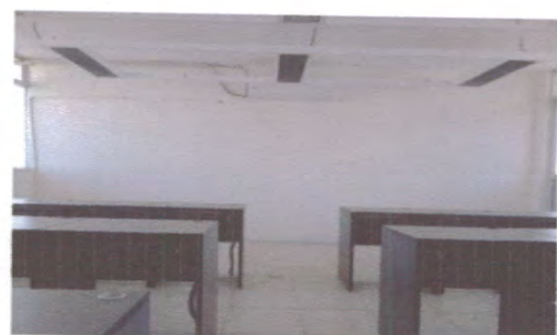
F4: Vista del interior de un aula terminada en el tercer nivel
