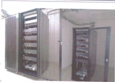
F3: Gabinetes dentro de los site de segundo y tercer nivel
