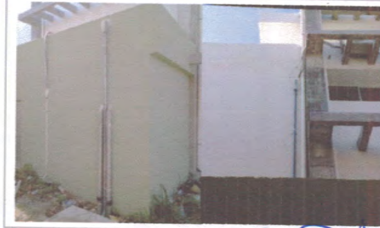
F5: Vista de la alimentación de internet 2 nos axes del edificio
