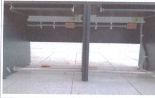
F2: Vista de los nodos de internet así como de los contactos eléctricos
