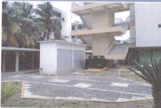
F3: En esta fotografía se observa el transformador ya colocado, así como el cuarto de tableros terminado, solo esperando la pintura exterior.
