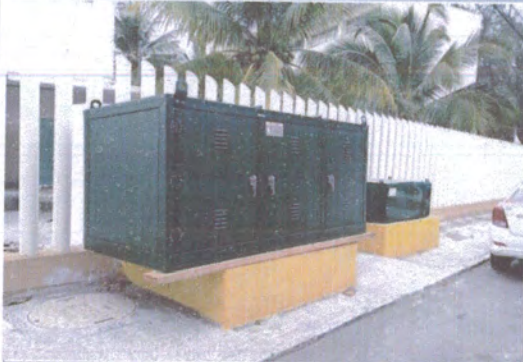
F1: En esta fotografía se observa que el transformador y el equipo de medición ya fueron montados sobre sus bases de concreto. Estos equipos se encuentran sobre la banqueta de la calle Costa Dorada.
