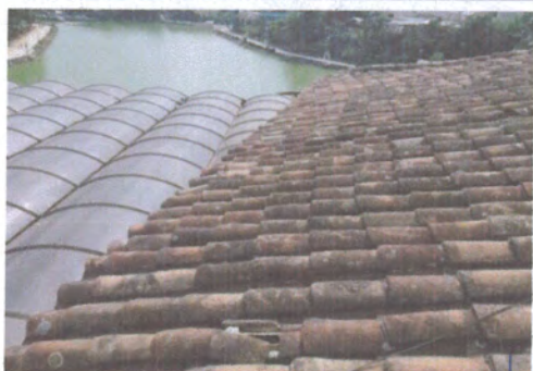
F3: Estado actual intersección de cubiertas
