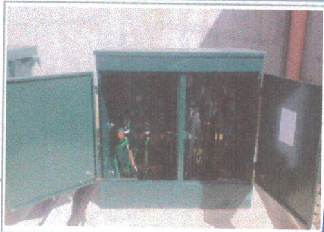
F3: Edificio (B) Transformadores
