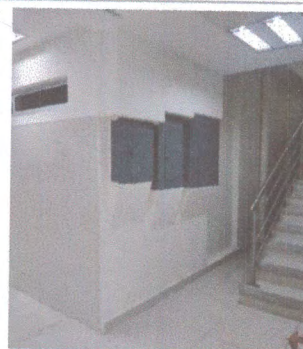
F4: Instalación eléctrica
