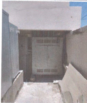
F1: Subestación eléctrica
