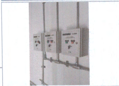
F3: Equipo de control de bombeo
