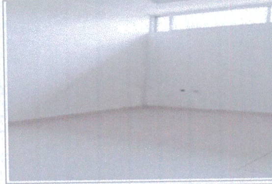
F2: Interior de módulo
