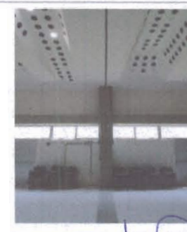
P5: SONOMUROS EN SALA DE VIDEOCONFERENCIAS
