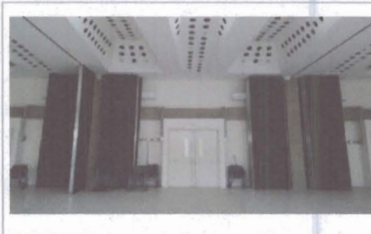
P4: SONOMUROS EN SALA DE VIDEOCONFERENCIAS
