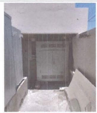
F1: Subestación eléctrica
