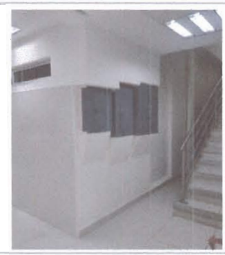
F4: Instalación eléctrica
