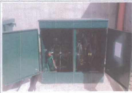
F3: Edificio (B) Transformadores
