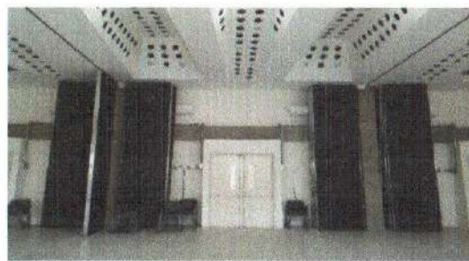
F4: SONOMUROS EN SALA DE VIDEOCONFERENCIAS
