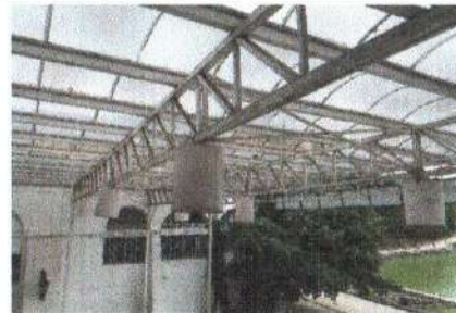
P2: Estado actual de la estructura
