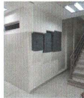
F4: Habitación eléctrica
