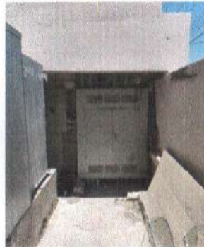
F1: Subestación eléctrica
