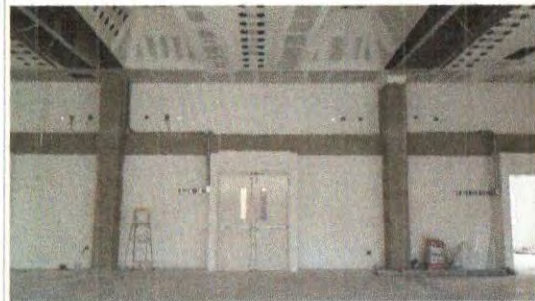
F4: SONOMUROS EN SALA DE VIDEOCONFERENCIAS
