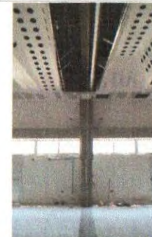
F5: SONOMUROS EN SALA DE VIDEOCONFERENCIAS
