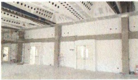
F3: SONOMUROS EN SALA DE VIDEOCONFERENCIAS
