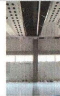
F5: SONOMUROS EN SALA DE VIDEOCONFERENCIAS
