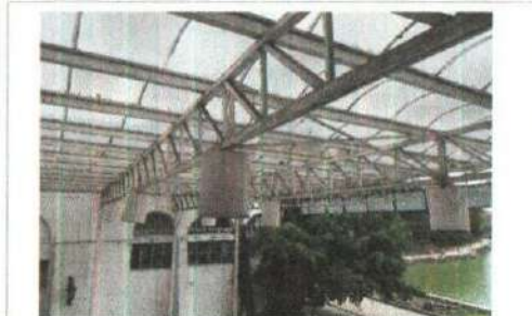
P2: Estado actual de la estructura
