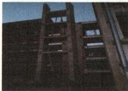
F3: Rampas de acceso
