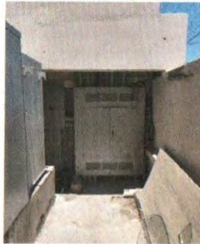
F1: Subestación eléctrica
