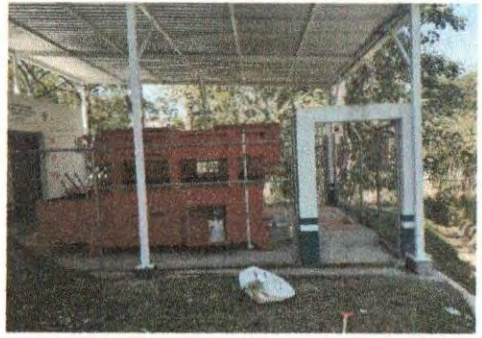
F1: Vista frontal de la planta de tratamiento
