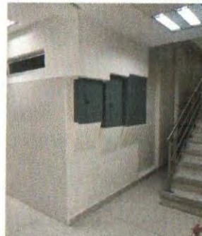
F4: Instalación eléctrica
