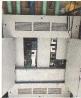
F1: Vista tableros junto a transformador
