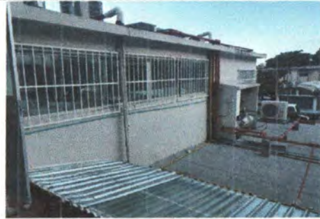
F2: Líneas eléctricas por azotea
