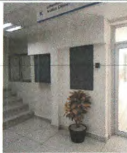
F3: Revisión de tableros de control
