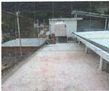
F3: Estado del impermeabilizante
