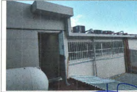
F5: Líneas eléctricas por azotea
