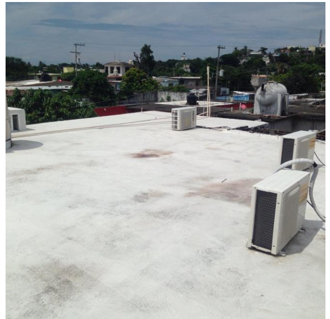
Fig. 21) Condensadores de los aires acondicionados.
