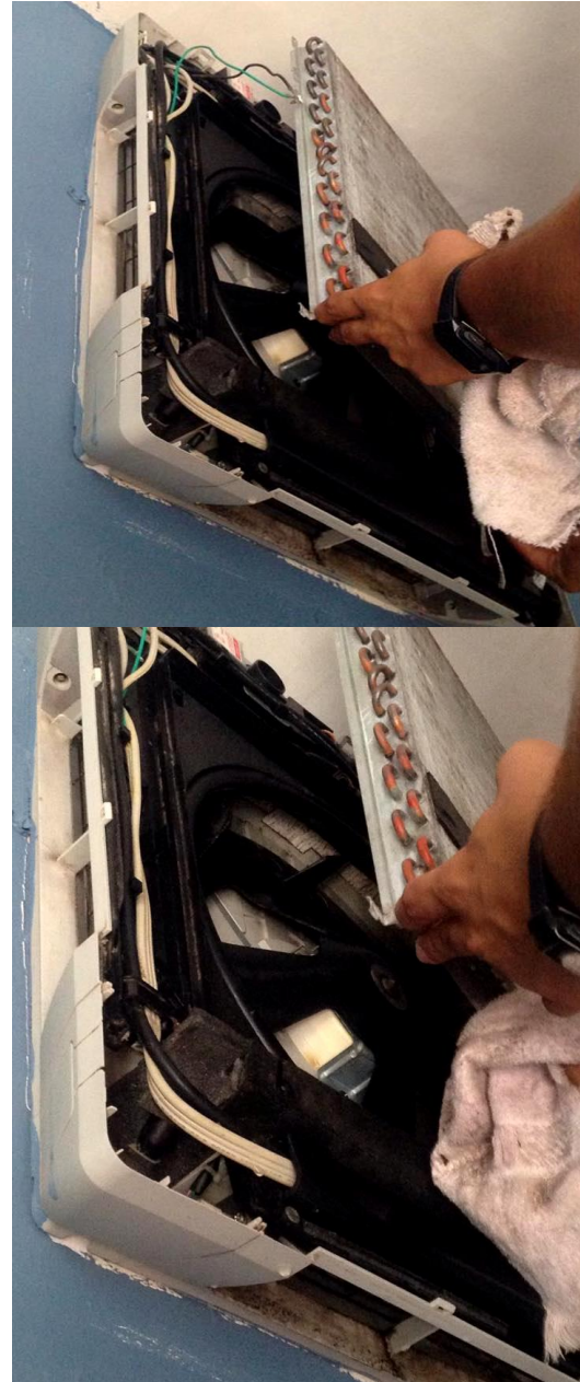
Fig. 5) Ventilador del primer equipo, Dándole también su limpieza.
