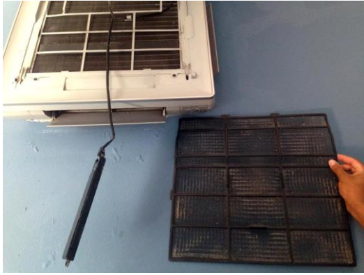
Fig. 6) Filtro del aire acondicionado.
