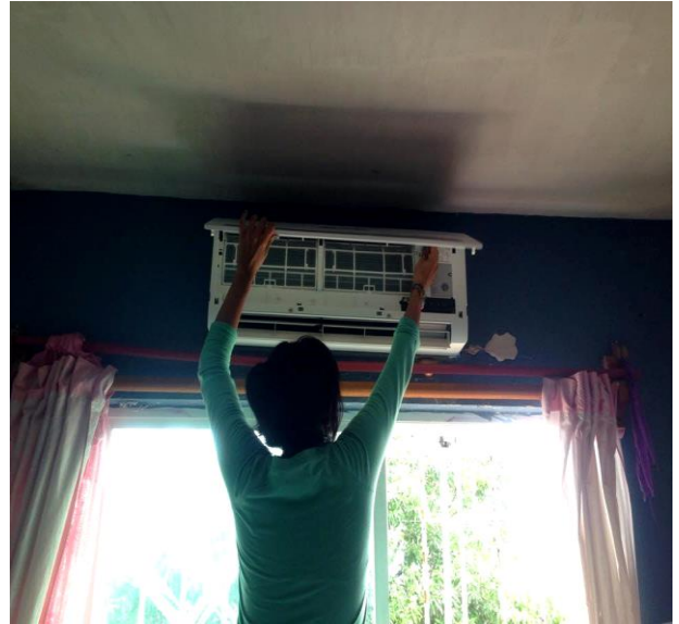
Fig. 9) Segundo equipo para realizar la limpieza. Solo se limpiaron los filtros, el evaporador no se encontraba sucio porque no se usa de manera constante.
