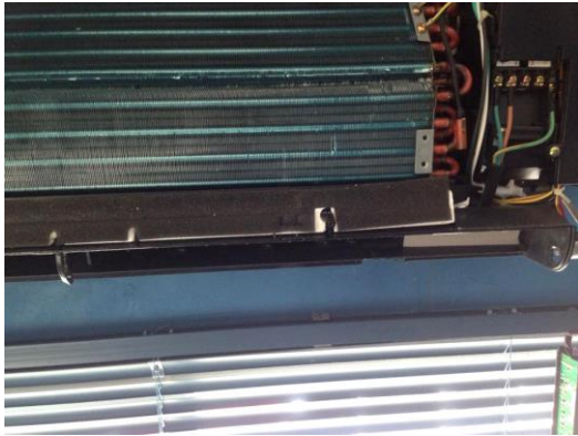
Fig. 14) Evaporador descubierto. En condiciones buenas.
