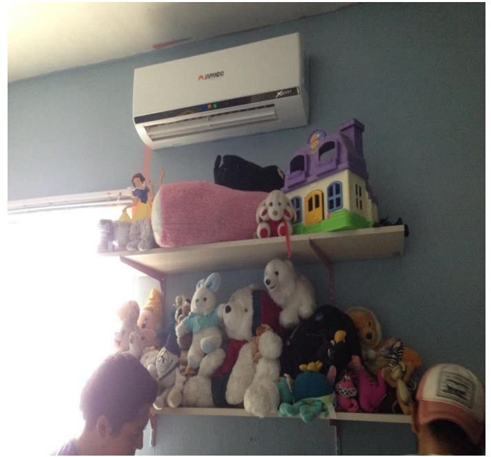
Fig. 20) Equipo finalizado para su uso
