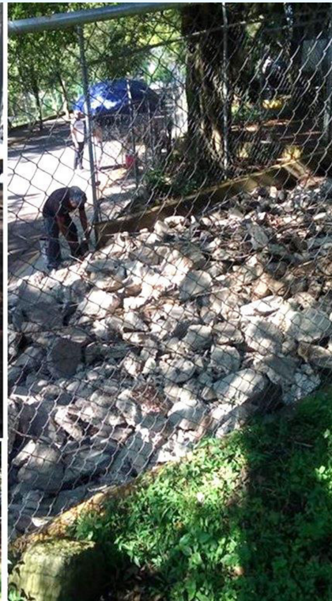
Demolición de rampa sobre el acceso Principal del Estacionamiento; que se encontraba hundido y Fracturado.
