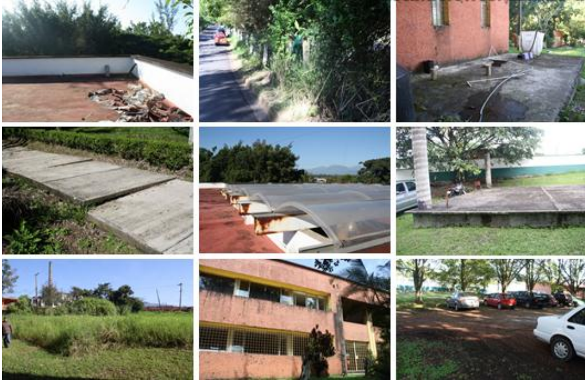
Espacios físicos de la Facultad mostrando aspectos que requieren atención en la planta física
