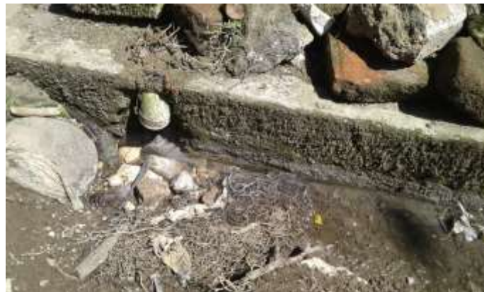
FIGURA 5.4 TUBERÍA DE SALIDA DE AGUAS GRISES DE UNA VIVIENDA EN LA COLONIA MARIANO ESCOBEDO
