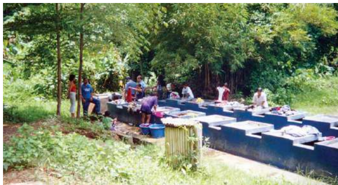
Lavaderos comunitarios con fosa de infiltración para evitar la contaminación de la fuente de agua. Este tipo de proyecto es demandado por las comunidades. Chagualtique, Jiquilisco, El Salvador.
