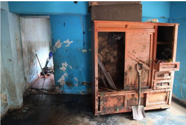
Imagen 6.- Inundación por fuertes lluvias. Fuente: Jaime Rivera. Diario de Xalapa, 2020.
