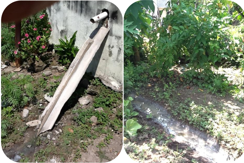
Figura 5. Canalización de aguas residuales
