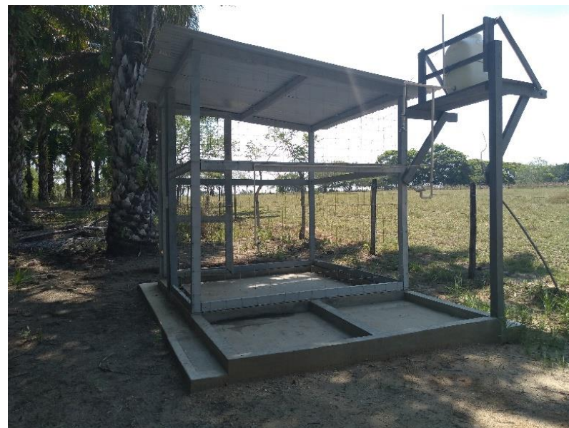
Ilustración 20. Bodega para almacenamiento de residuos y regadera de emergencias en el palmar de JH, en proceso de certificación, ejido Miguel Hidalgo II. Mayo, 2021.
