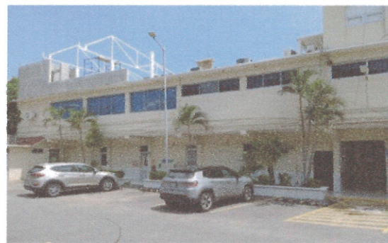
F4: Fotografía tomada desde el estacionamiento del edificio donde se observa la fachada del Edificio "C", así como los muros ya levantados.
