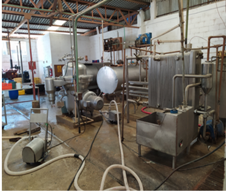
Zona insegura por falta de orden durante la limpieza del clarificador. Fuente: Perla Y. Cruz-Martínez (2021).
