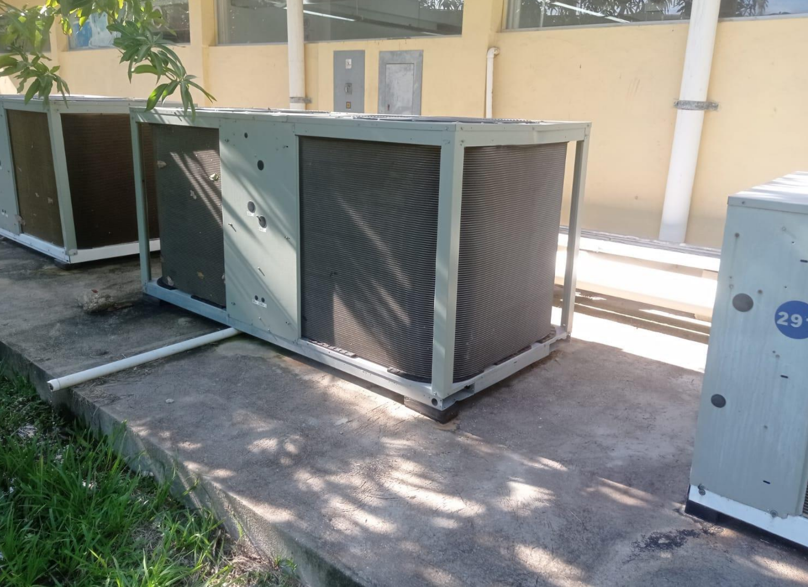
Condensadores que proveen el servicio de aire acondicionado de la USBI Coatzacoalcos. Foto: USBI Coatzacoalcos.
