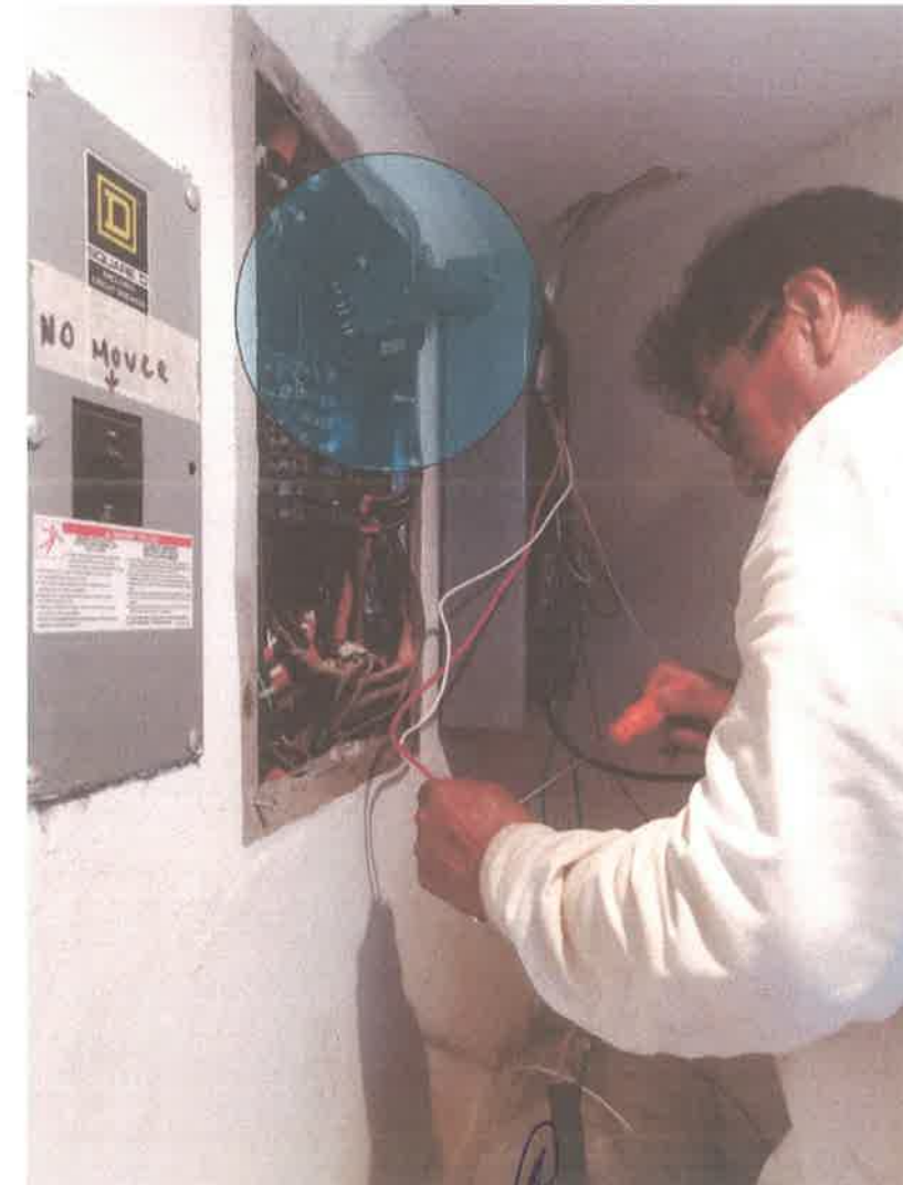
INTERRUPTOR EN TABLERO EXISTENTE DE 3PX100 AMP
