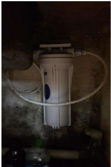
Mantenimiento de filtros de agua del Orquidario
